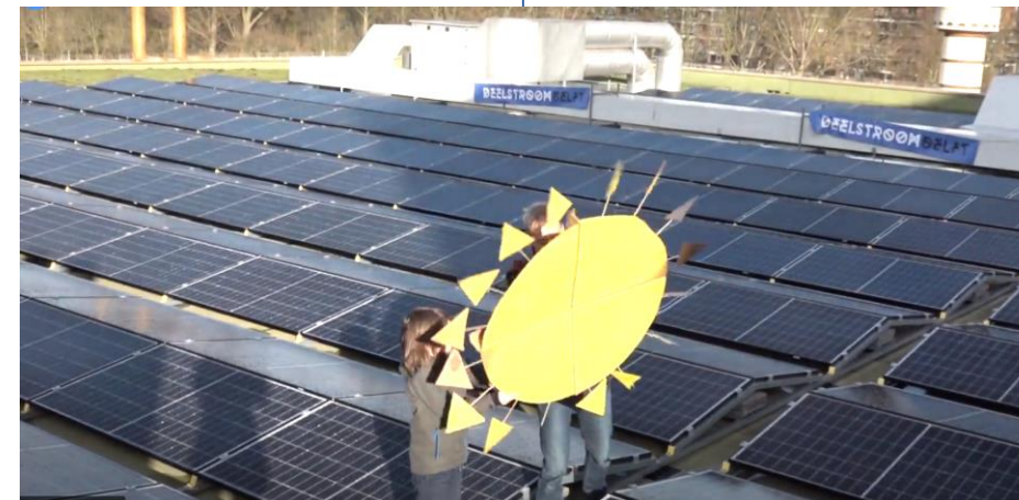
Sporthal Buitenhof o Realisatie mei 2021 o 432 panelen van 345 Wp o 125.000 kWh per jaar
